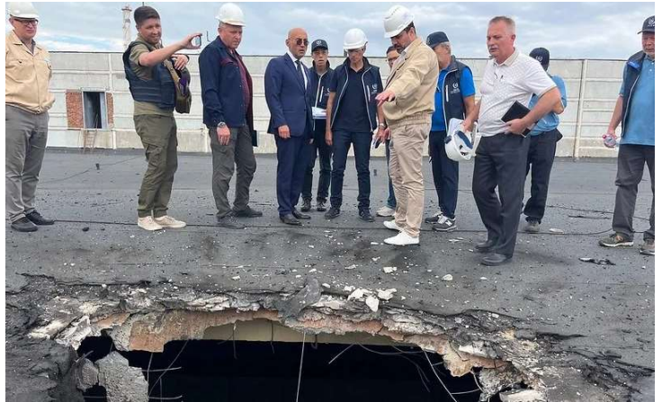
Наслідки влучання у спецкорпус СК1 ЗАЕС
