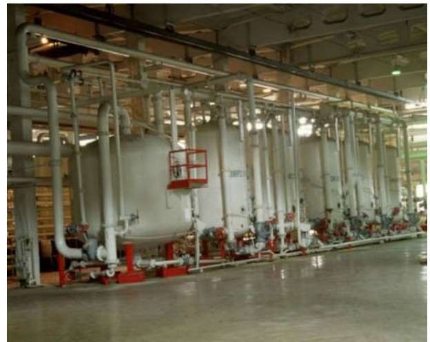
Центральний зал хімводоочищення
