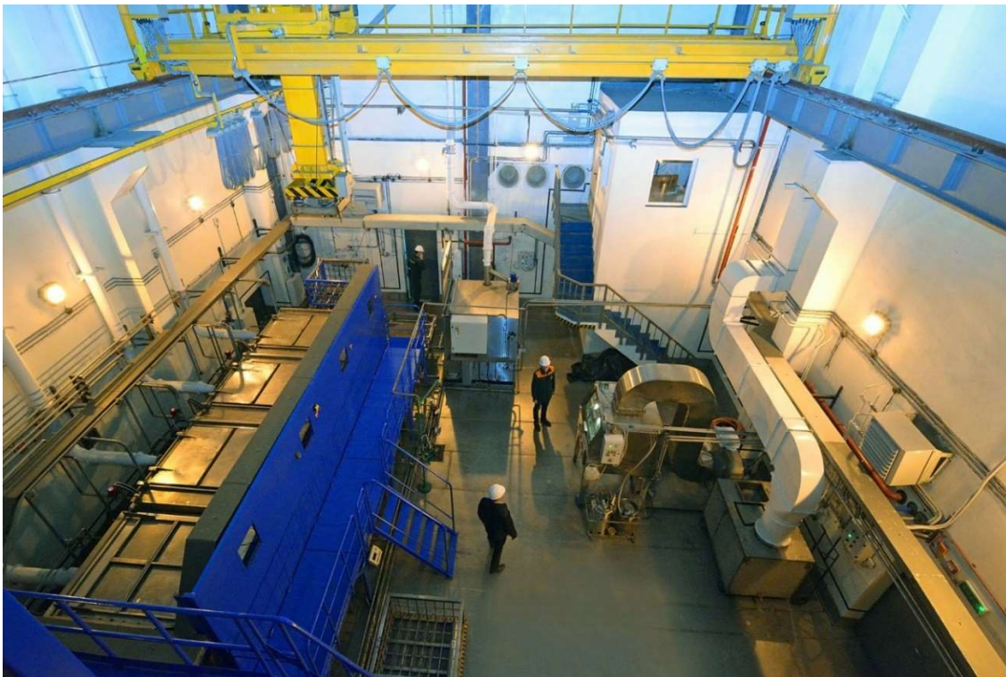
Установка дезактивації металу
